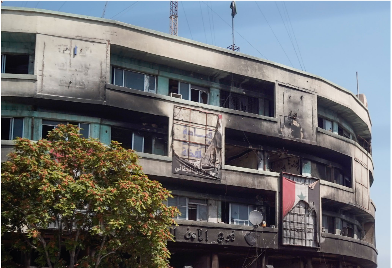
فرع الأمن الجنائي في دمشق؛ أضرمت النيران في المبنى عقب سقوط الحكومة، ويُرجح أن الهدف من ذلك كان إتلاف الوثائق التي تنطوي على أدلة إدانة.
