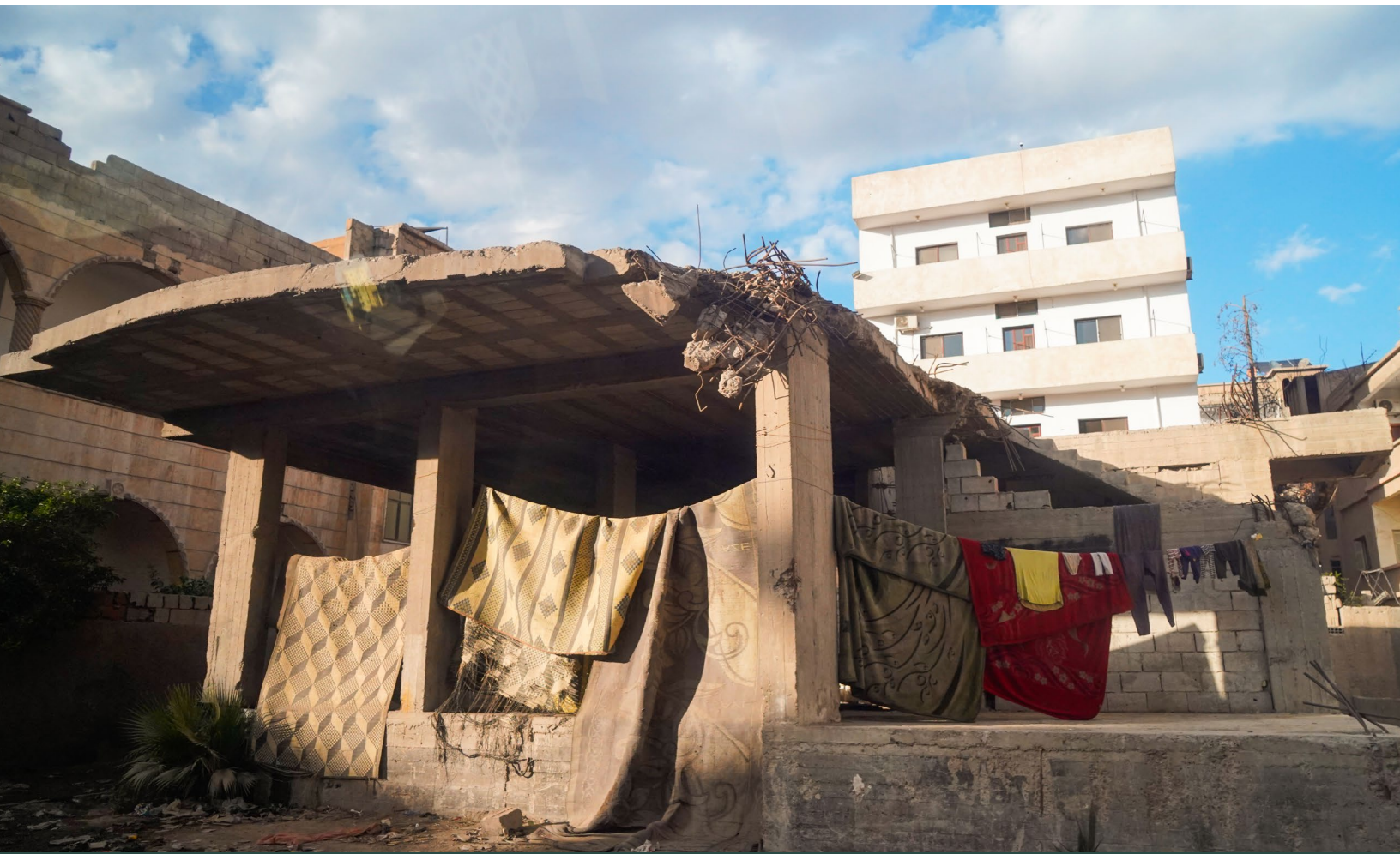
مبنى مدمّر في الرقة يُستخدم كمأوى مؤقت.
